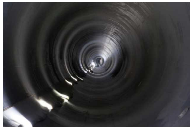
【埼玉県さいたま市】 南部第10処理分区白幡2号幹線
